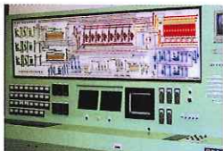
この操作盤で、カントリーエレベーター内の機器装置の全ての監視操作を行います。
